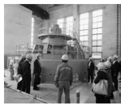
〈生保内発電所〉発電機
