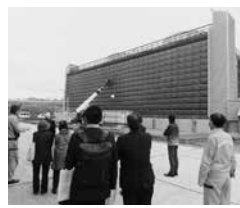
〈澄川地熱発電所〉冷却塔
