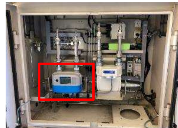
メーターボックス内部(エコハウス)
