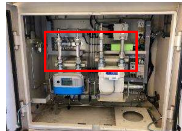
メーターボックス内部(エコハウス)
