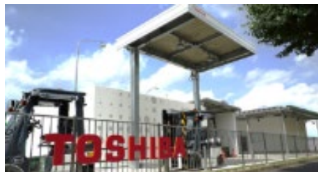
再エネ水素ステーション
